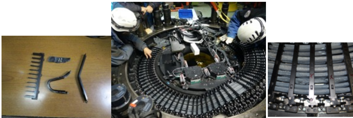
図 1 破損部品(左)、Cs AG ローテータケーブル巻取り(中)、ケーブルのよじれ箇所(右)
