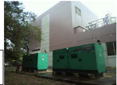
図 19.高度環境試験棟 非常用発電機
