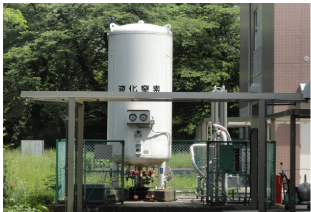
図 9. 液化窒素貯蔵製造設備
