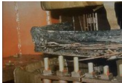
変電所の破壊
